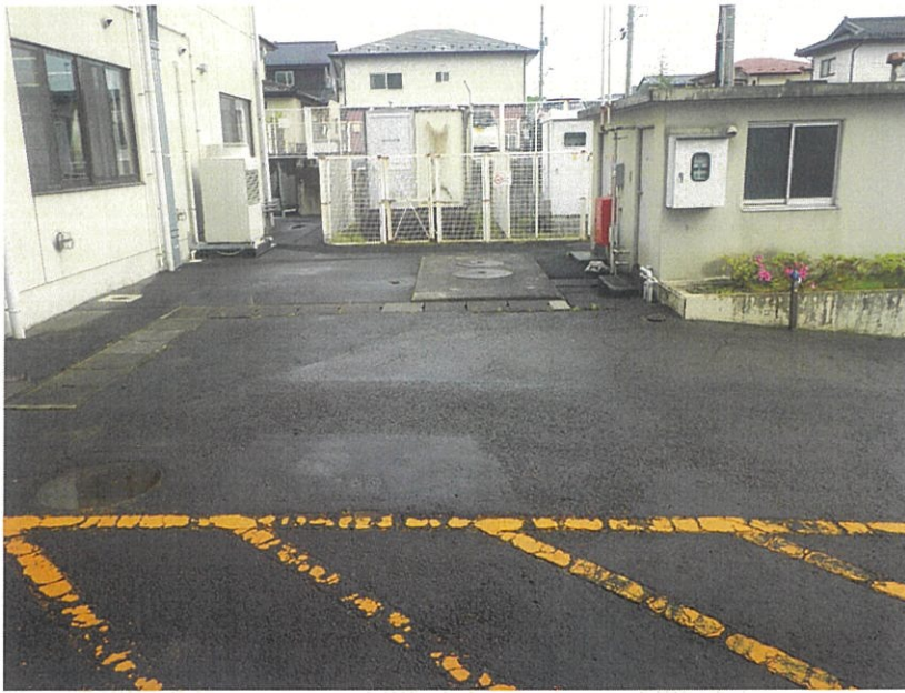
あけの平公民館 構内全景 受電設備更新 (単相変圧器更新)
