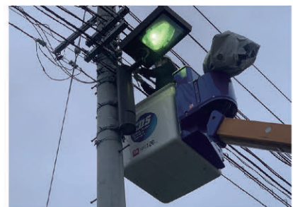
街路灯・防犯灯のLED化を進めています
