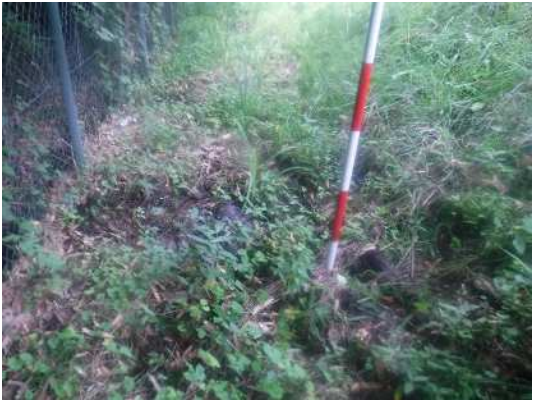
写真③④ 盛土のり尻湧水状況
