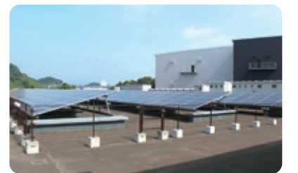
屋上に設置されたソーラーパネル
