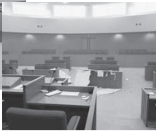
▲平成23年3月11日議場の天井落下
