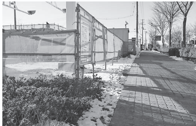
▲ 点字ブロックの無い歩道(明石台六丁目・郵便局新設地前)
