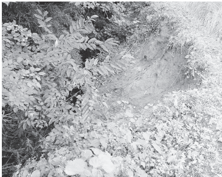
▲ 明石地区の崩落
