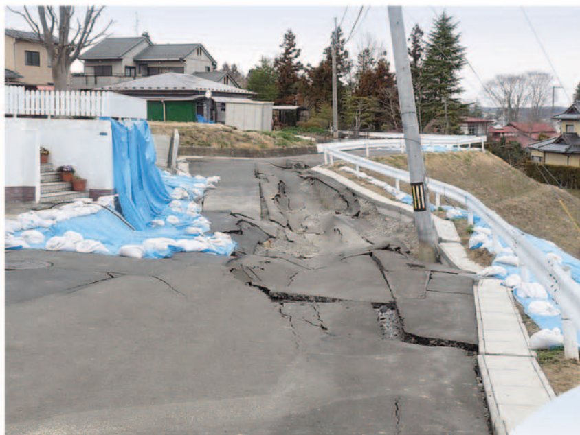
陥没した太子堂二丁目の町道
