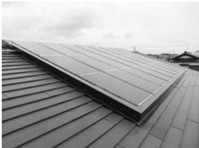
▲ 太陽光発電パネル（鷹乃杜防災センター）
