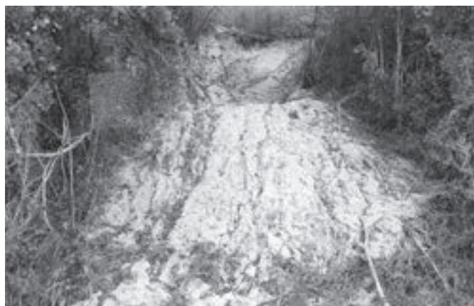
▲ 豪雨災害被災現場
