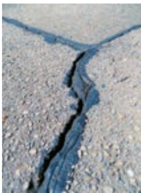
▲ 道路のひび割れ (成田)
